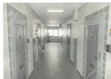
▲各階に照明器具を取り付け、明るい共用部になっている
